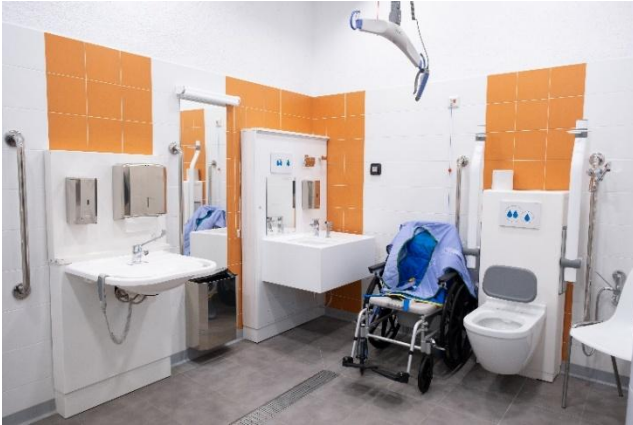
Imagen 4: Interior de un Cambiador GAMAN
